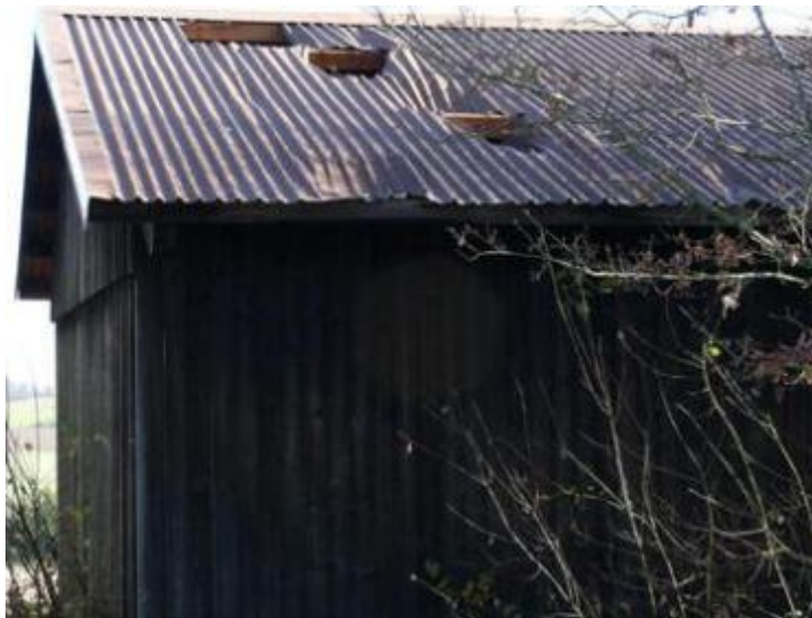
Eisgeschosse von einem 130 Meter entfernten Windrad haben ein Scheunendach bei Ehingen durchschlagen. Zum Glück haben sie kein Schädeldach getroffen
